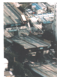
地震で崩壊した阪神高速道路
